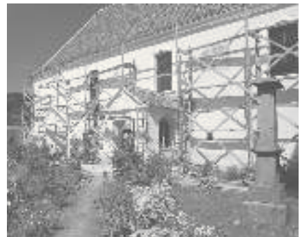
Renovierungsarbeiten in Kirchengemeinden aller Regionen: Leschkirch (unten), Sächsisch-Regen (oben rechts) und Groß-Alisch (Mitte rechts).
