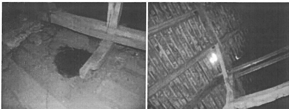
Foto nr.80,81 Învelitoare degradată
