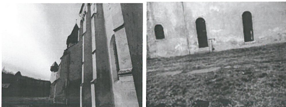
Foto nr.12,13 Apele meteorice se colectează și se scurg la baza fundației într-un sistem de canalizare subteran
