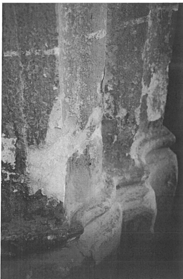
Eflorescențe saline pe suprafața unui pilastru
