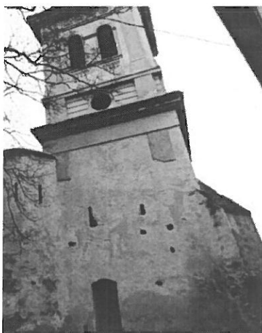
Foto nr. 119 Umiditate ascensională
