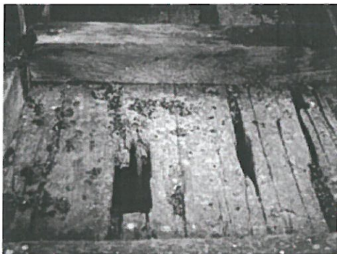
Foto nr.133 Podea degradată de atacuri fungice
