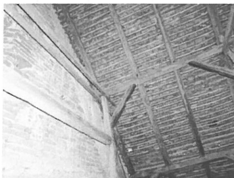
Foto nr.70 Căpriori cu urme de infiltrații
