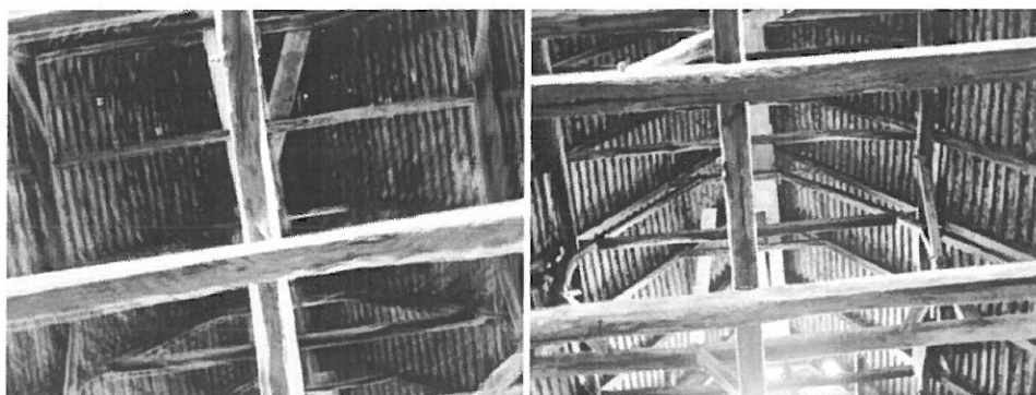
Foto nr.86,87 Coamă cu halouri de umiditate
