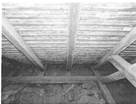
Foto nr.79 Cosoroabe acoperite de resturi de țigle sparte
