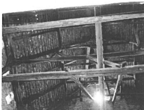
Foto nr.88 Elemente șarpanta cu halouri de umiditate
