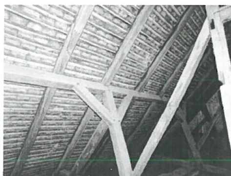
Foto nr.69 Căpriori și popi cu urme de infiltrații
