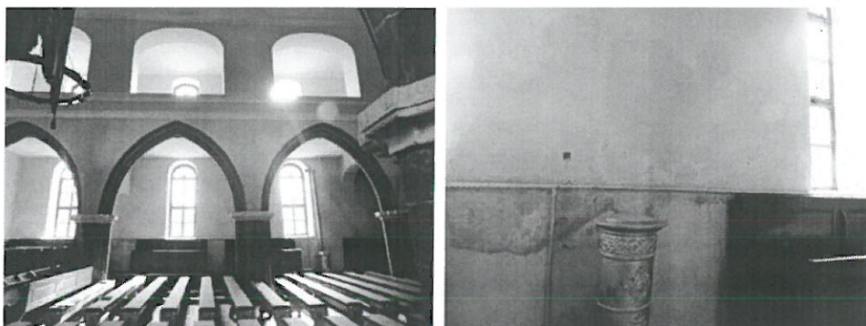
Foto nr.25,26 Umiditatea ascensională este mai scăzută în zona de sud
