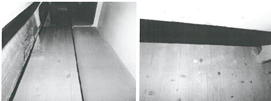
Foto nr.19 Pardoseală confecționată din brad Foto nr.20 Pardoseală cu atac de insecte xilofage
