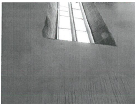
Foto nr.41 Infiltrații ale apelor pluviale, prin ferestre.
