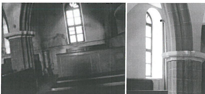
Foto nr.27,28 Infiltrații în zona ferestrelor
