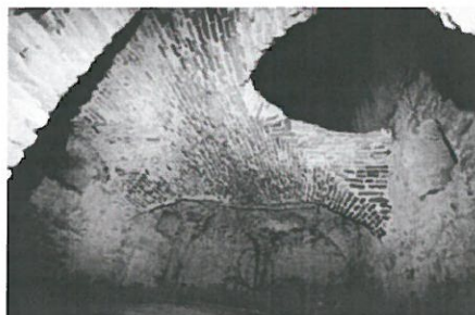
Foto nr 145 Boltă degradată
