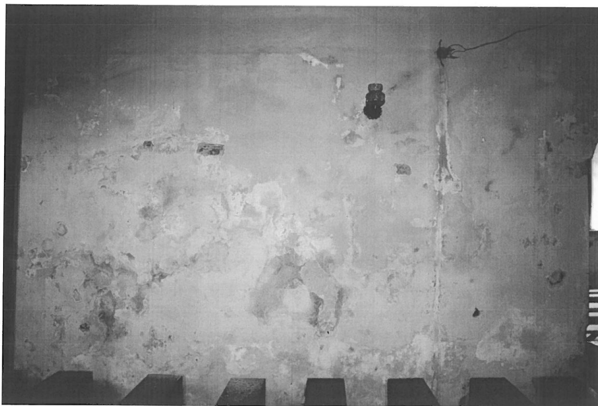
Peretele nordic al navei. Umiditate capilară cauzată de tencuielile cu ciment
