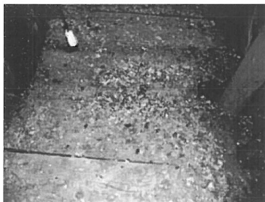
Foto nr.102 Excremente păsări pe pardoseală
