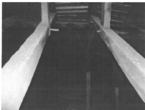
Foto nr.73 Dolie șarpantă adiacentă zona de nord.
