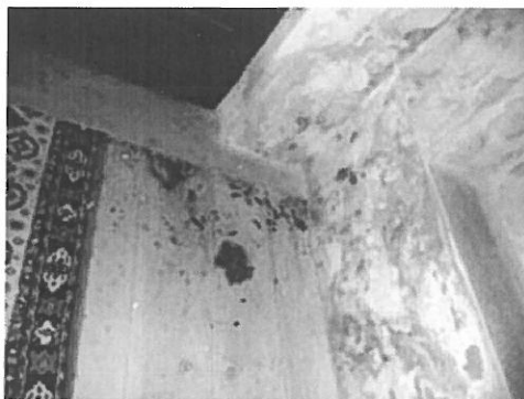
Foto nr.28 Pardoseală cu atac fungic
