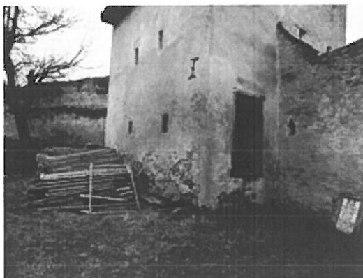
Foto nr.117 Umiditate ascensională
