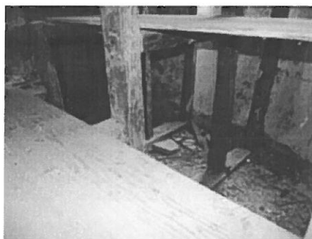
Foto nr.32 Podea degradată
