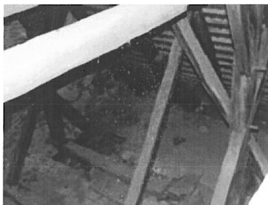
Foto nr.87 Podea degradată
