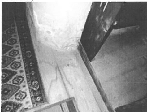
Foto nr.19 Pardoseală cu halouri de umiditate
