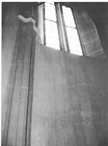
Foto nr.35 Infiltrații ale apelor pluviale, prin ferestre.
