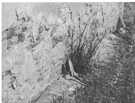
Foto nr. 109 Umiditate ascensională
