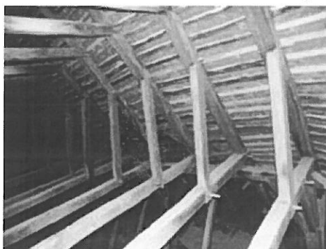
Foto nr.69 Căpriori cu urme de infiltrații
