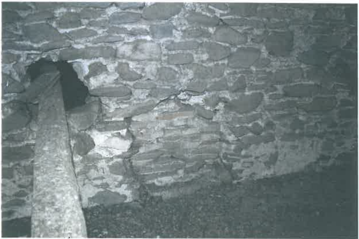
Zidul sudic al navei principale- zona podului. Fereastră circulară înzidită din perioada romanică (?)
