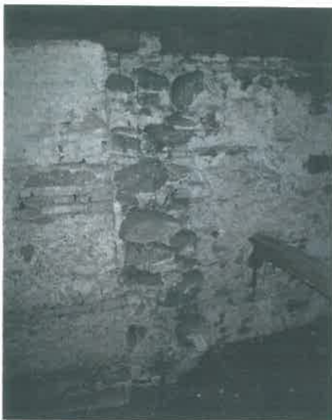
Zidul sudic al navei laterale sudice. Se observă extinderea din sec XVIII. Extinderea este realizată din cărămidă.
