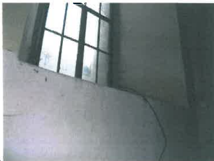
Foto nr.23 Infiltrații ale apelor pluviale, prin ferestre.
