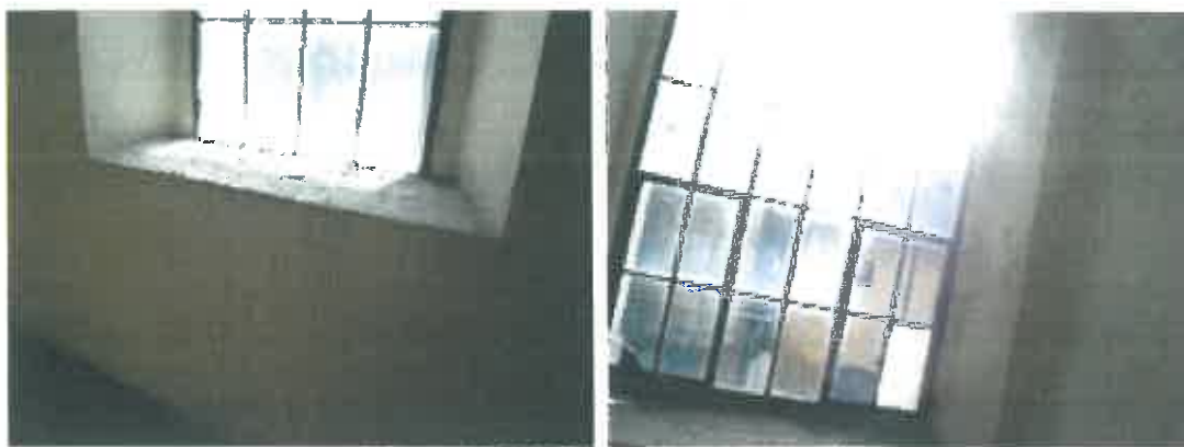
Foto nr.19, 20 Infiltratii in zona ferestrelor
