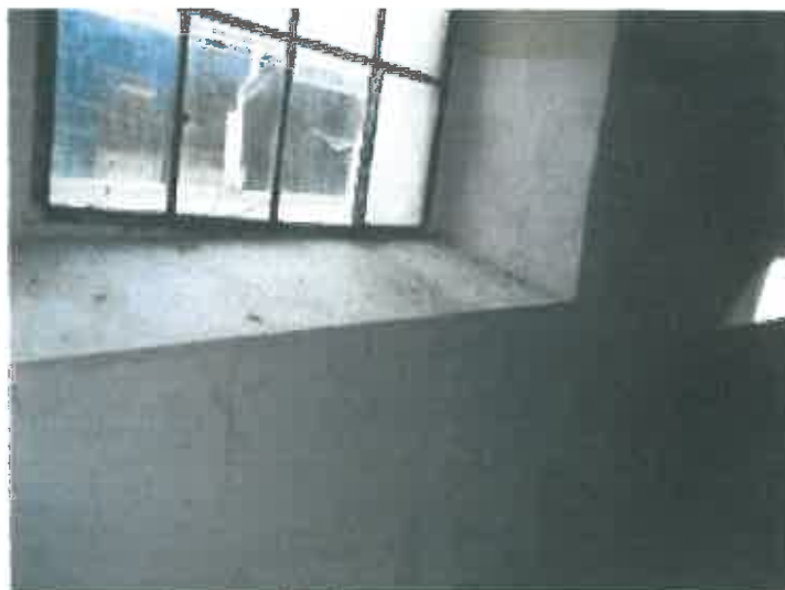
Foto nr.9 Infiltrații în zona ferestrelor
