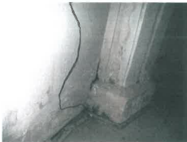
Foto nr.22 Alge verzi dezvoltate pe zidarie
