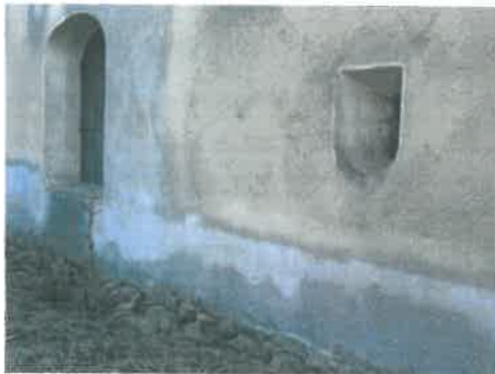
Foto Nr.3 Umiditate ascensională, pe exterior
