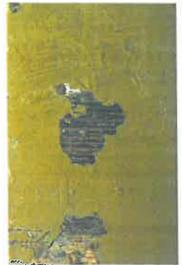
Detaliu cu desprinderea stratului de revopsire pe băncile din nava centrală, unde se observă un strat de pictură mai vechi, tip floder
