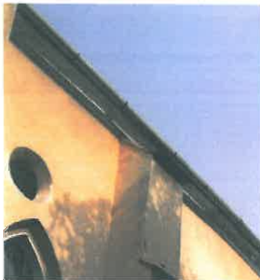
Foto nr.7 Zonă unde se înfiltrează apele pluviale
