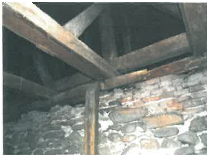
Foto nr.50 Cosoroaba degradata
