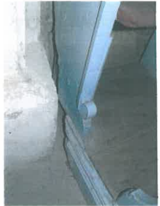
Grinzile de talpă ale stranelor sunt degradate
