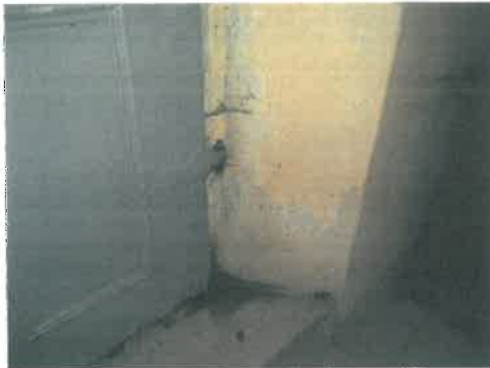
Foto nr.10 Halouri de umiditate in zona ușii.
