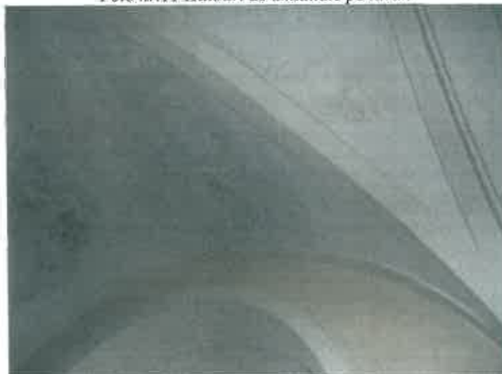
Foto nr.12 Zone cu infiltrări ale apelor meteorice prin tavan
