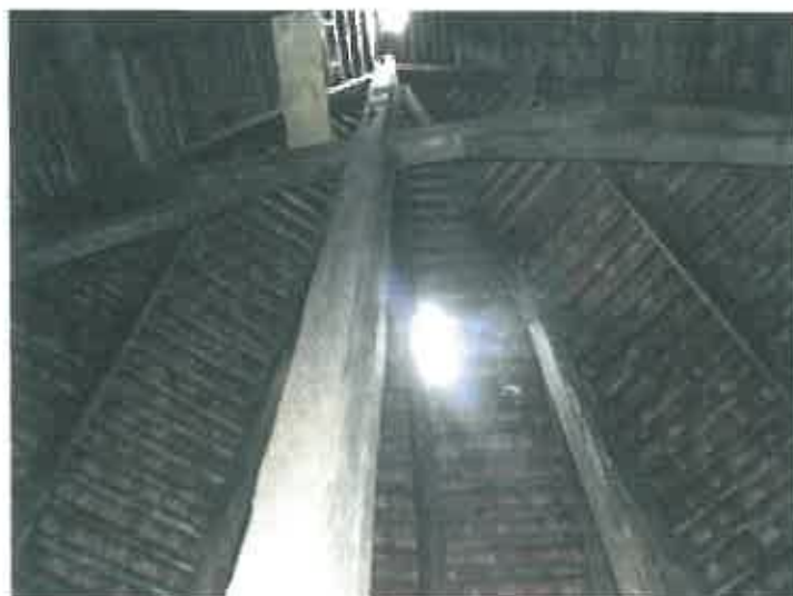
Foto nr.52 Coame și elemente cu halouri de umiditate
