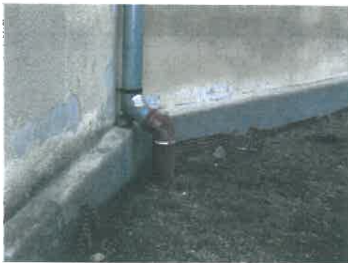
Foto nr.4 Izolatie orizontala
