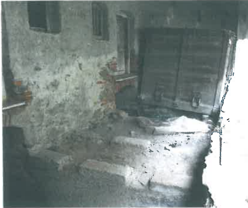
Starea de conservare a lăzilor
