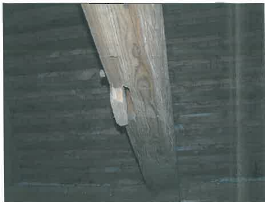
img. 45 Nod dislocat - șarpanta peste nava laterală nord
