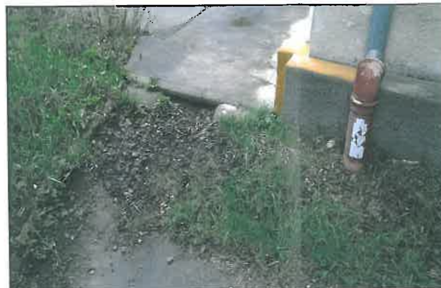
img. 21 Traseul colmatat al apelor pluviale sub platforma de acces din partea de sud
