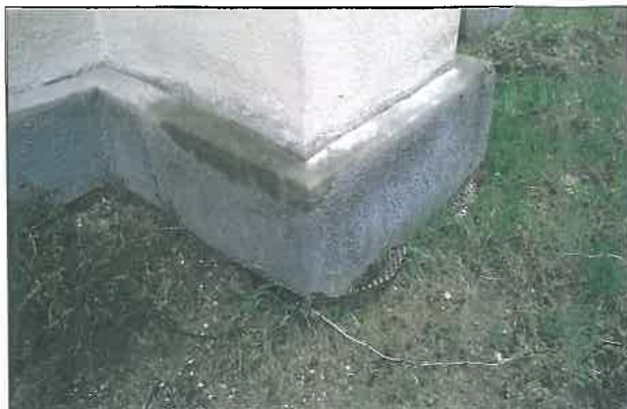
img. 20 Soclu din beton protejat de folie amprentată la fațada spre sud și spre est
