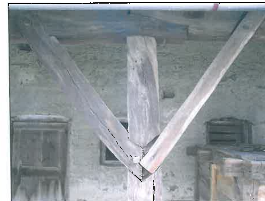
img. 63 Reparații neadecvate la nivelul îmbinărilor elementelor structurale din lemn
