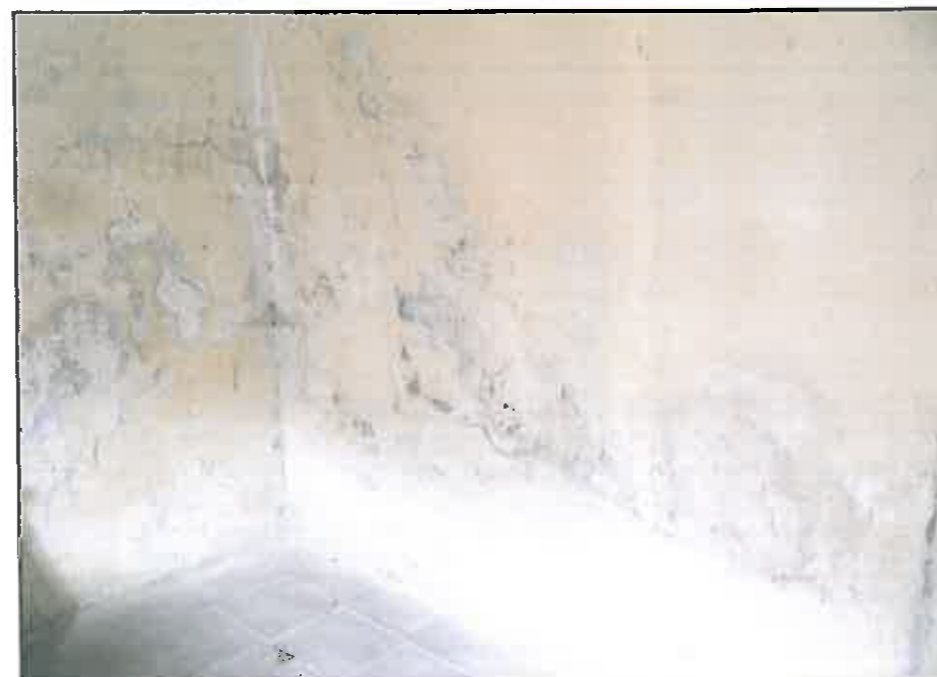
img. 36 Degradări ale tencuielilor în interiorul sacristiei
