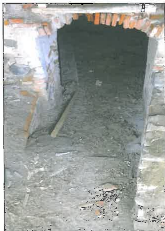
img. 61 Degradări locale ale arcelor și bolților din cărămidă la spațiile de depozitare la nivelul pivnițelor
