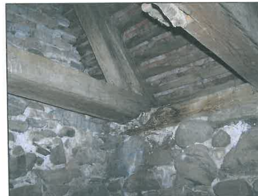
img. 47 Cosoroabă degradată la șarpanta navei laterale nord
