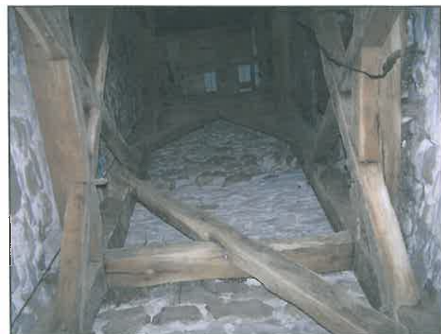
img. 48 Degradări prin elemente lipsă sau dislocate la structura spațială în interiorul turnului de vest
