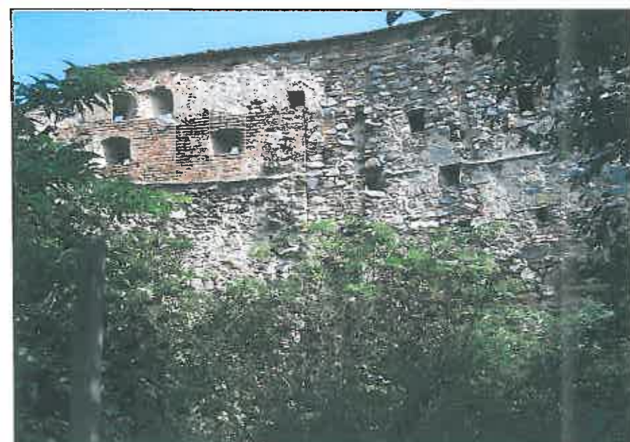
img. 73 Zidul de incintă - latura nord vest, vedere din interior
