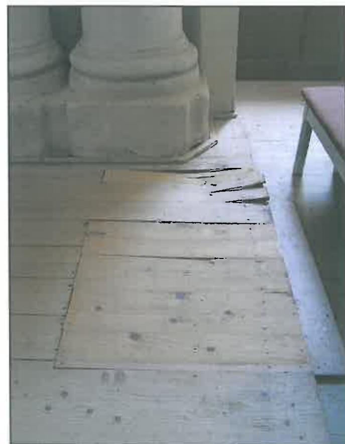
img. 35 Pardoseală degradată în zona corului
