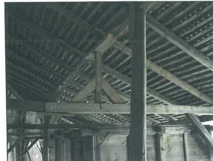
img. 66 Degradări locale a șarpantei în axul 8
