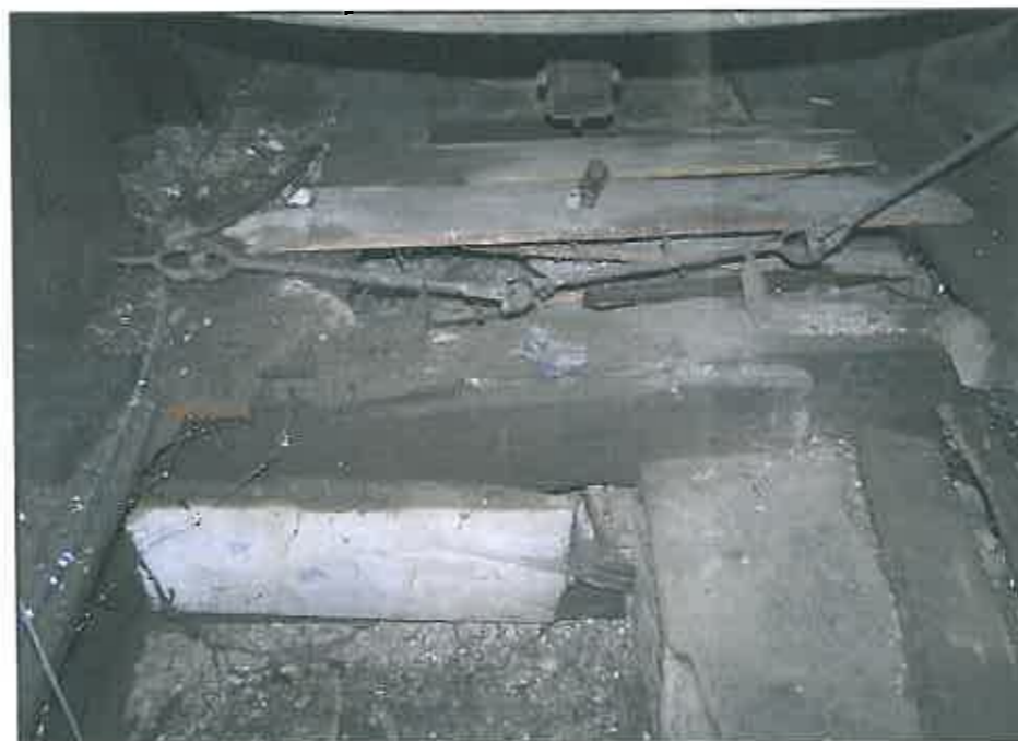
img. 49 Degradări la pardoseala nivelului drumului de strajă al turnului de vest sub clopotul mare
