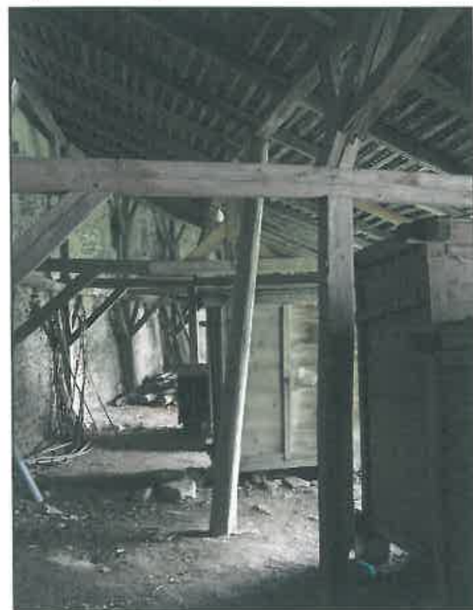
img. 67 Stâlp suplimentar de susținere a panei degradate între axul 7 și 9
