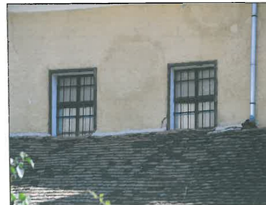
img. 69 Zonă neetanșă pentru apele meteorice în dreptul ferestrelor casei parohiale și acoperișul șopronului
