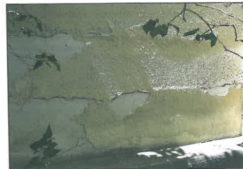
img. 22 Desprinderi locale a tencuielilor tip strop la toate fațadele
