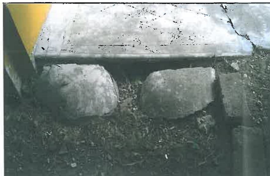
img. 76 Rigolă colmatată sub placa de beton în dreptul accesului sud în biserică
