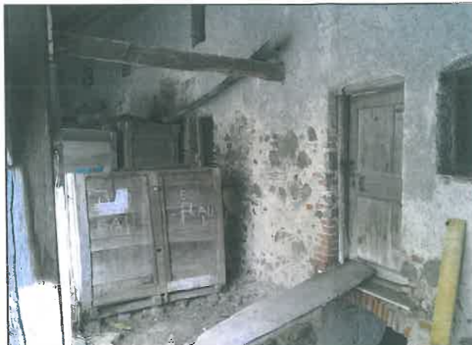
img. 59 Acces acoperit spre pivnițe și spre încăperile de depozitare ale nivelului 1
