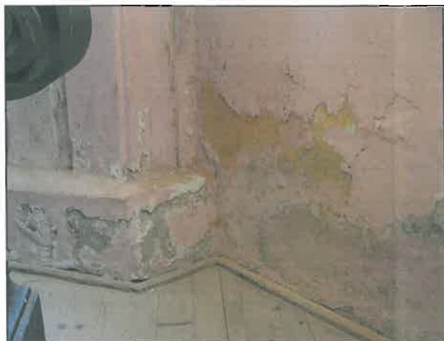
img. 32 Umiditate, săruri desprinderi ale tencuielilor cauzate de umiditate în zona corului
