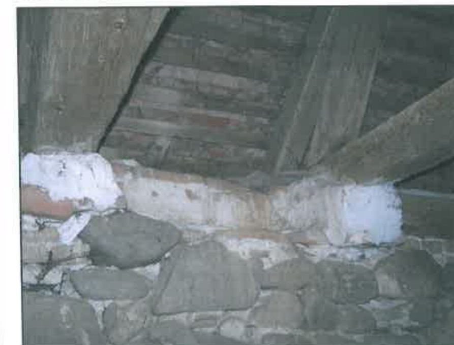
img. 50 Cosoroabă întreruptă la șarpanta navei laterale nord
