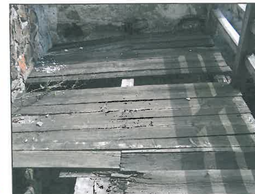
img. 56 Degradări la pardoseala terasei de la nivelul 1
