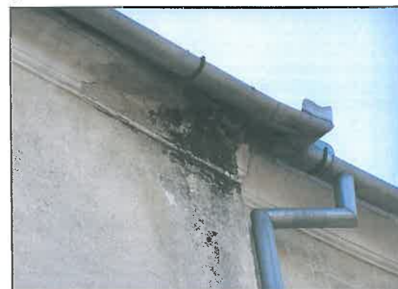
img. 27 Degradări locale la streașina înfundată, fațada nord
