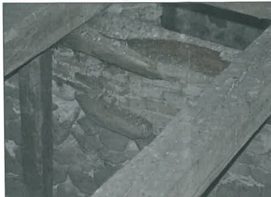
img. 46 Grindă talpă degradată la șarpanta navei
