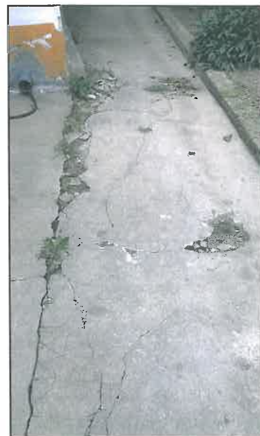
img. 79 Trotuar din beton adiacent turnului de poartă la interior
