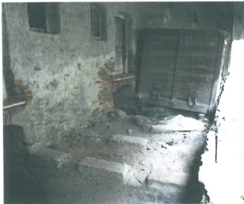
Starea de conservare a lăzilor
