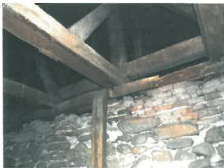
Foto nr.50 Cosoroaba degradata
