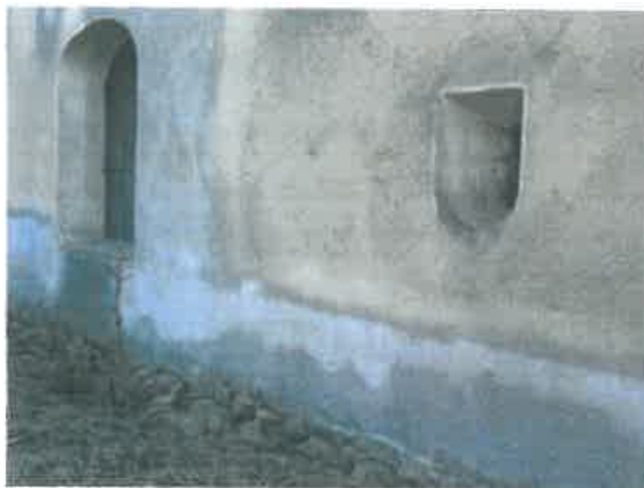
Foto Nr.3 Umiditate ascensională, pe exterior
