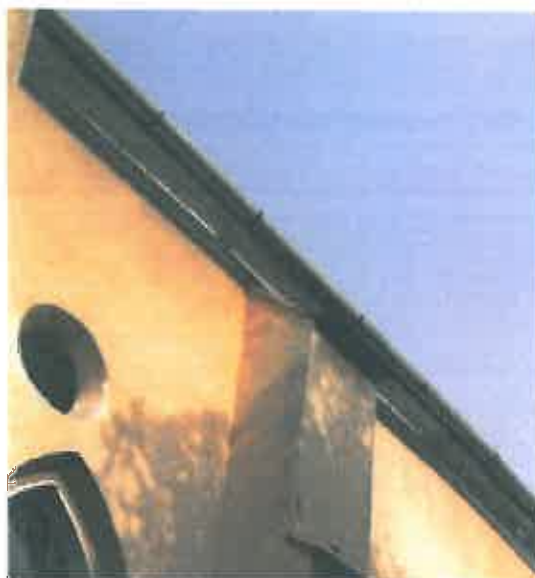
Foto nr.7 Zonă unde se infiltrează apele pluviale
