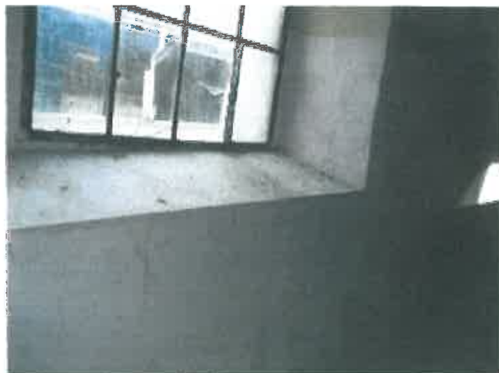
Foto nr.9 Infiltrații în zona ferestrelor
