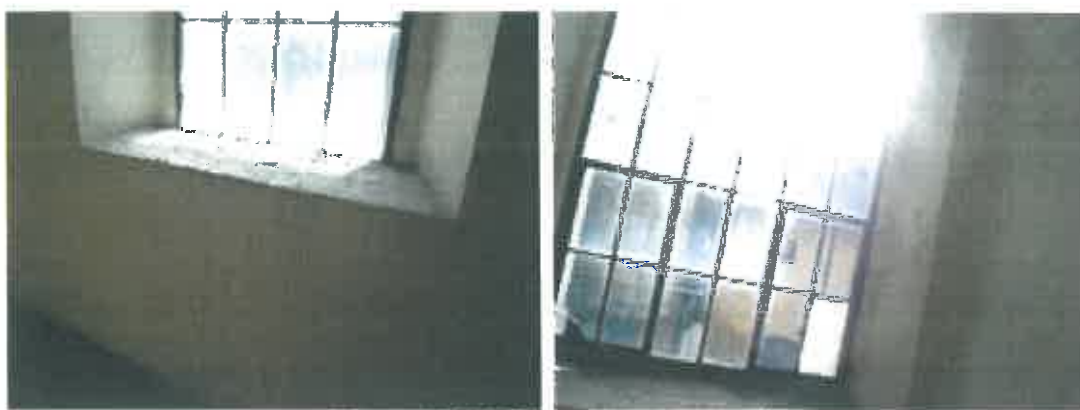
Foto nr.19, 20 Infiltratii in zona ferestrelor
