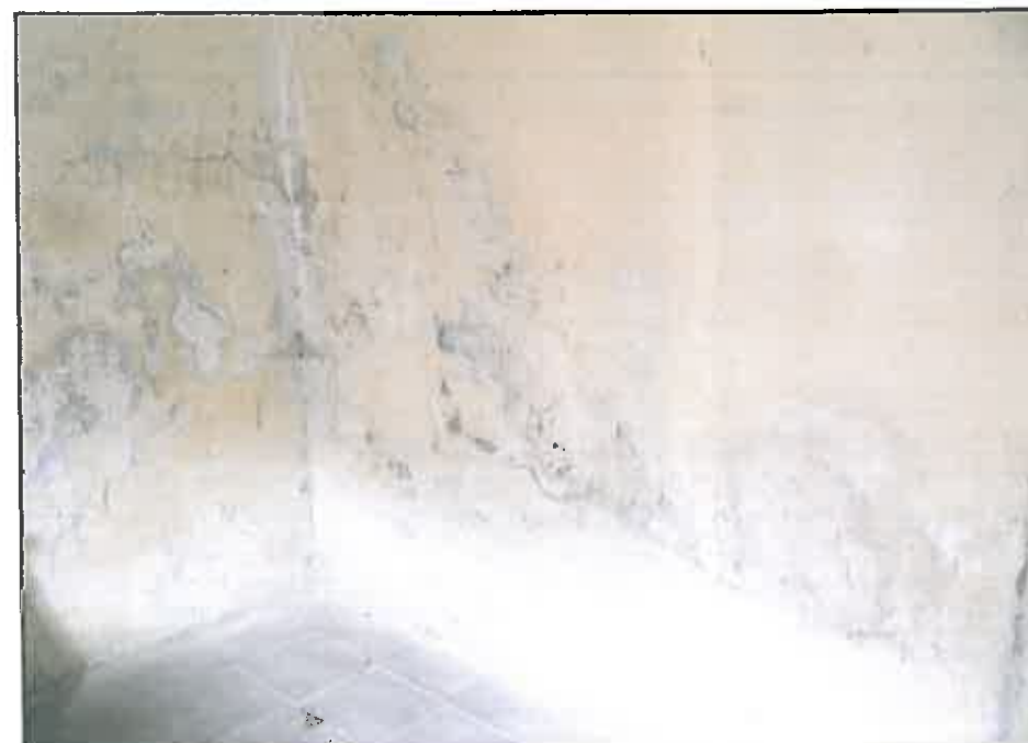
img. 36 Degradări ale tencuielilor în interiorul sacristiei
