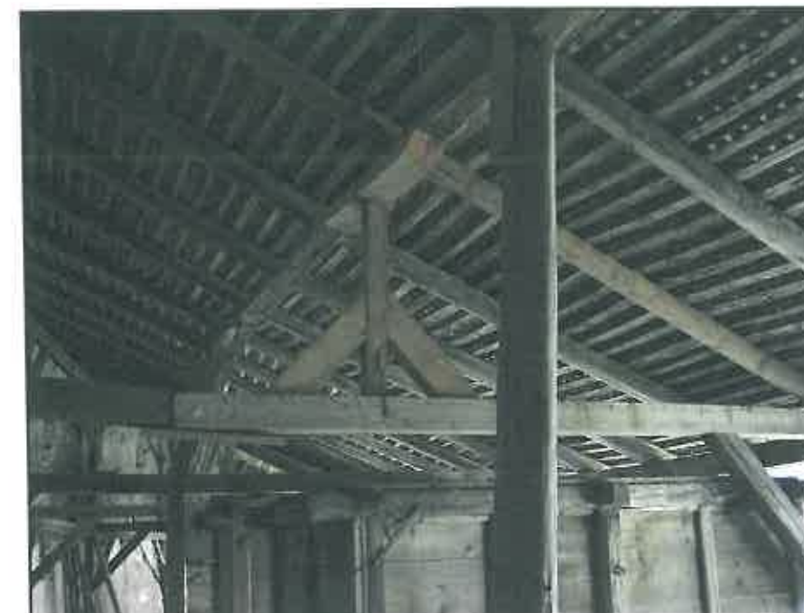
img. 66 Degradări locale a șarpantei în axul 8
