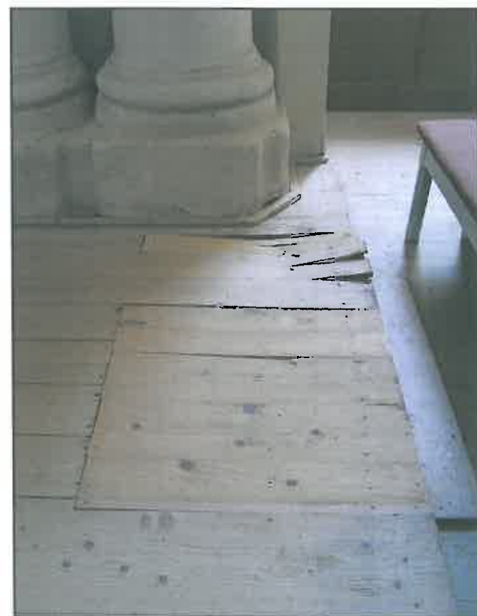
img. 35 Pardoseală degradată în zona corului
