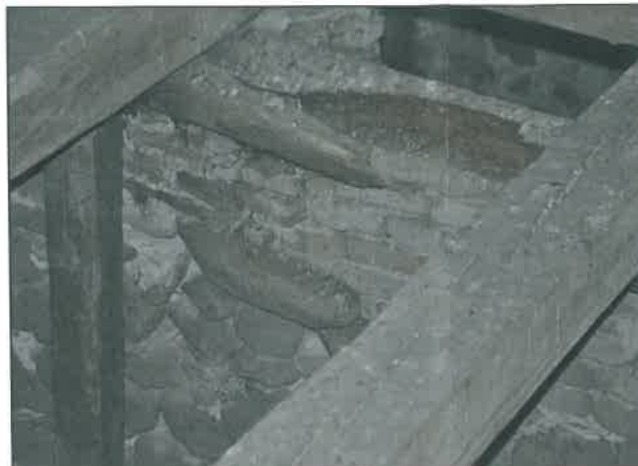
img. 46 Grindă talpă degradată la șarpanta navei
