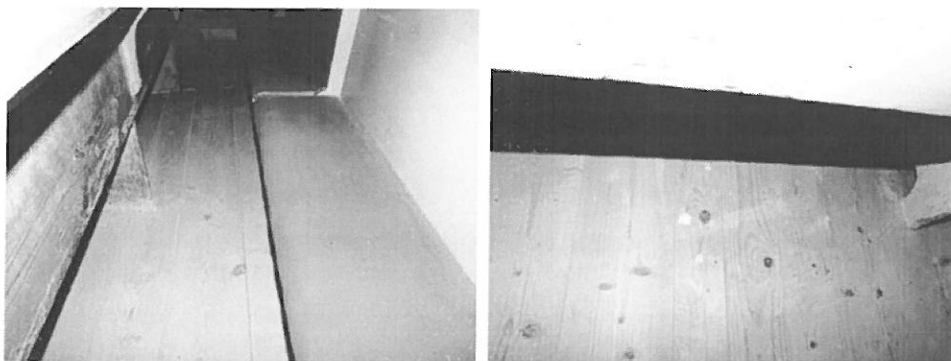
Foto nr.19 Pardoseală confecționată din brad Foto nr.20 Pardoseală cu atac de insecte xilofage
