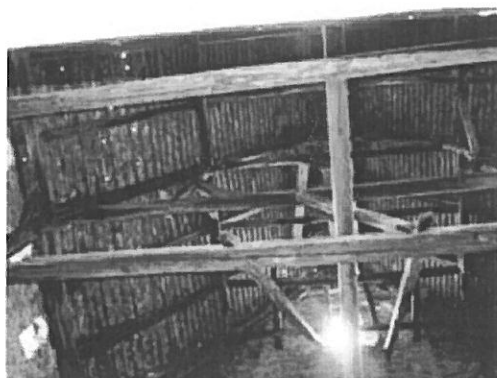
Foto nr.88 Elemente șarpantei cu halouri de umiditate
