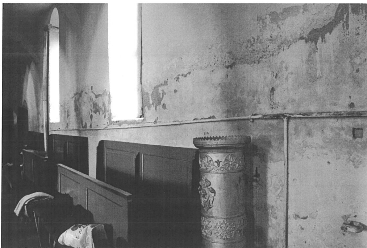
Peretele nordic al navei. Tencuială cu ciment și nivelul de călcare exterior au cauzat umiditate capilară.
