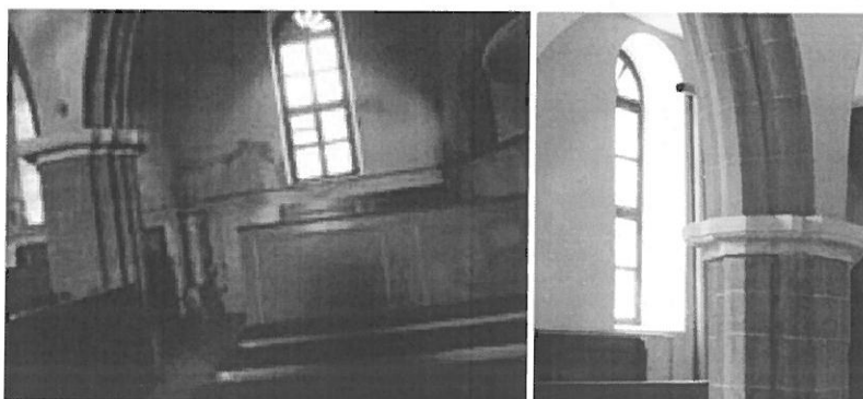
Foto nr.27,28 Infiltrații în zona ferestrelor
