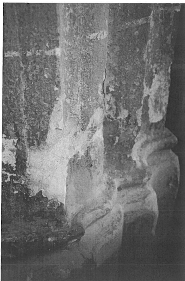
Eflorescențe saline pe suprafața unui pilastru
