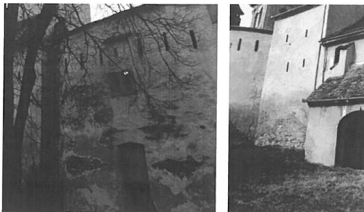
Foto nr.10,11 Umiditate ascensională, pe exterior
