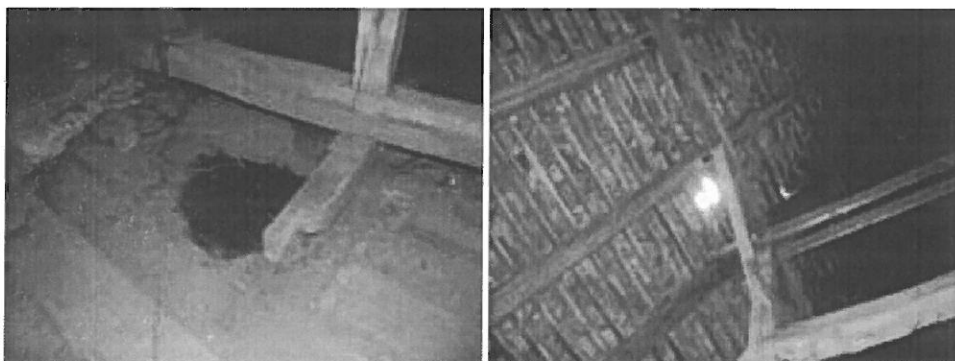
Foto nr.80,81 Învelitoare degradată
