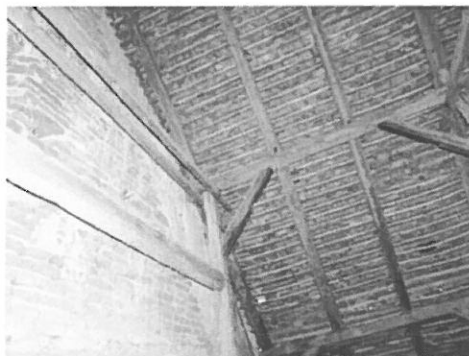
Foto nr.70 Căpriori cu urme de infiltrații
