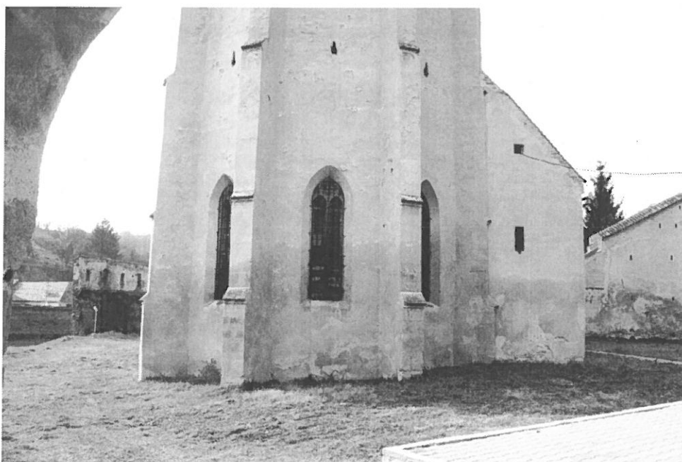
Latura estică a altarului. Poate fi observat nivelul umidității în ziduri, cât și nivelul ridicat de umplutură a nivelului exterior de călcare
