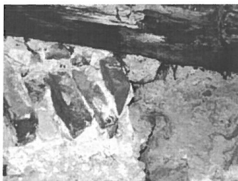
Foto nrr.106 Cosoroabă degradată
