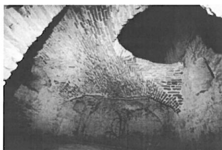
Foto nr145 Bolta degradata
