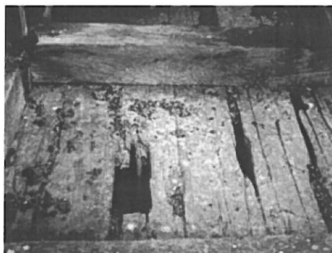
Foto nr.133 Podea degradată de atacuri fungice
