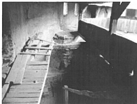
Foto nr. 150 Podea drum de strajă degradată-zona de est
