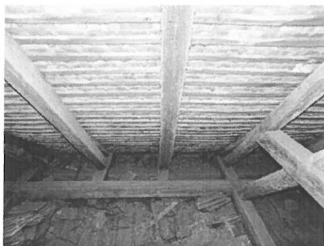
Foto nr.79 Cosoroabe acoperite de resturi de țigle sparte
