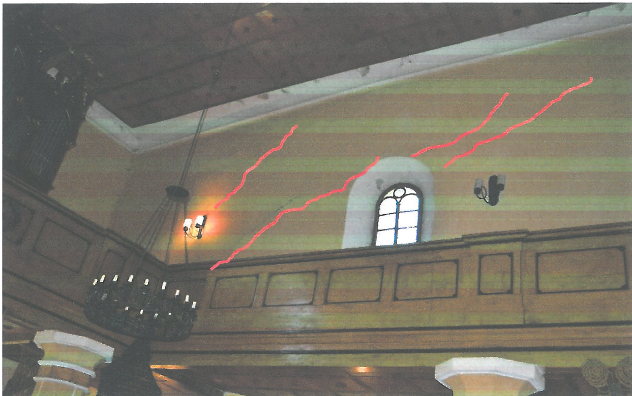
Foto 26 – Fisuri diagonale accentuate datorate tasarii terenului de fundare
