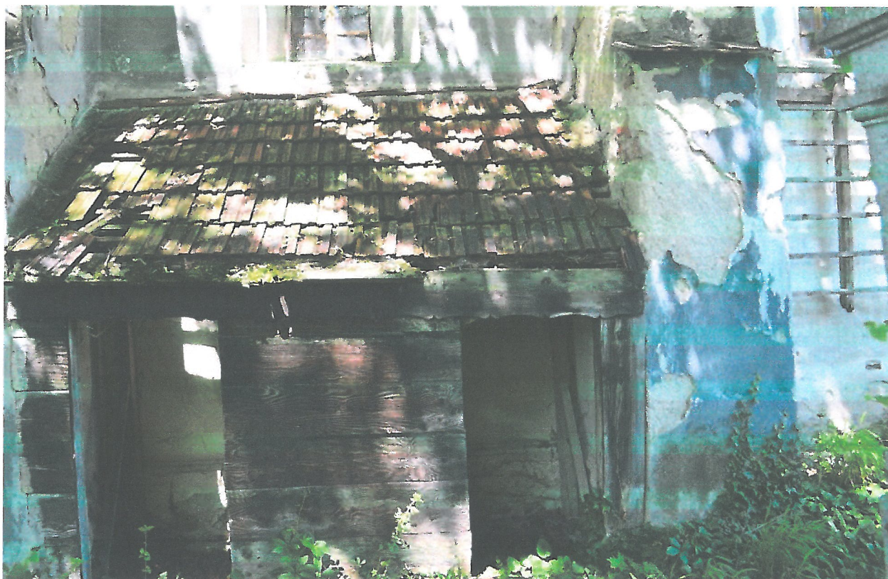
Foto 19 – Degradari la fatada sud
