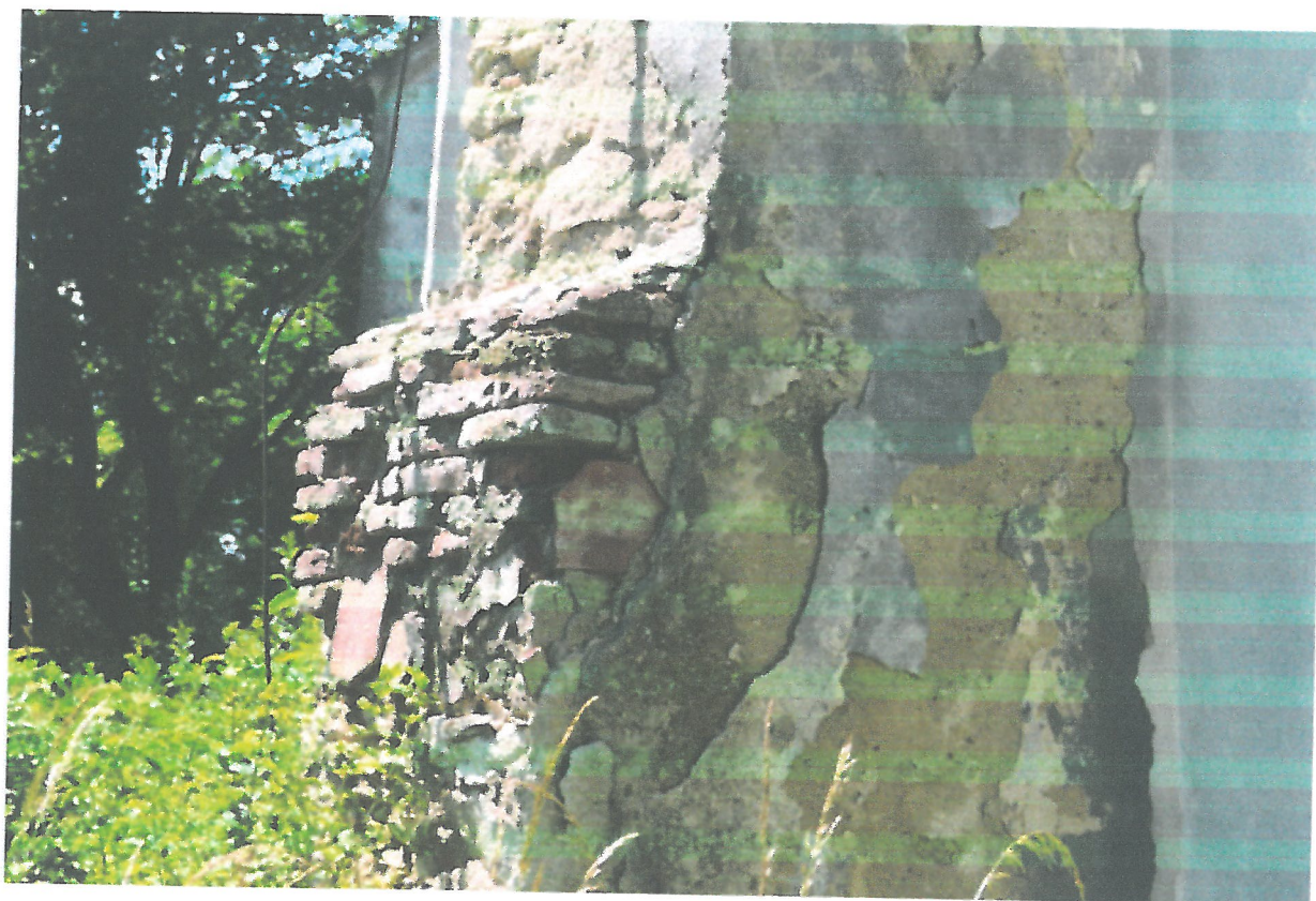
Foto 13 – Degradari la contrafortii altarului
