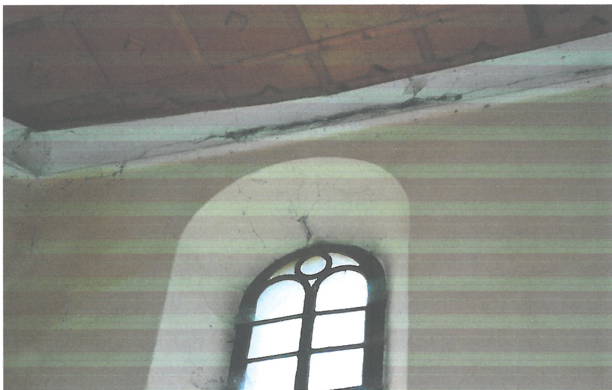
Foto 31 – Fisuri la arcele ferestrelor
