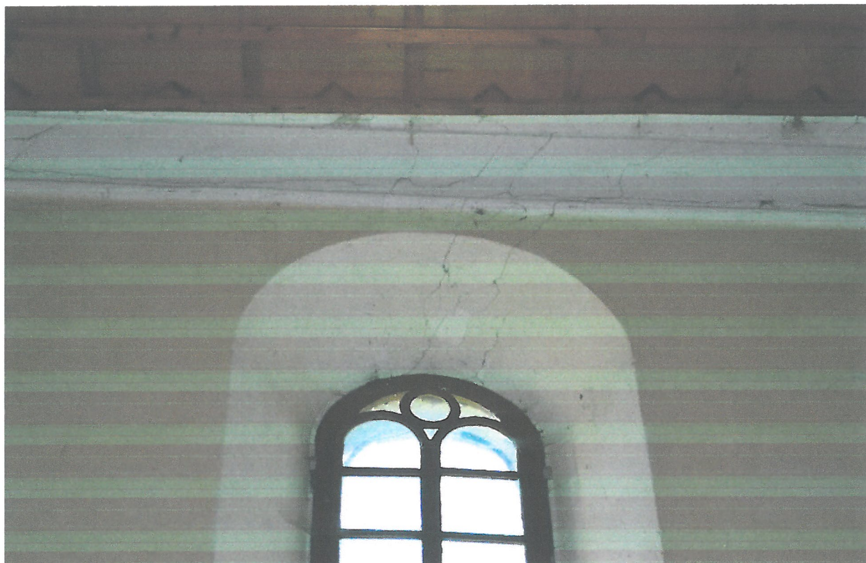
Foto 32 – Fisuri la arcele ferestrelor
