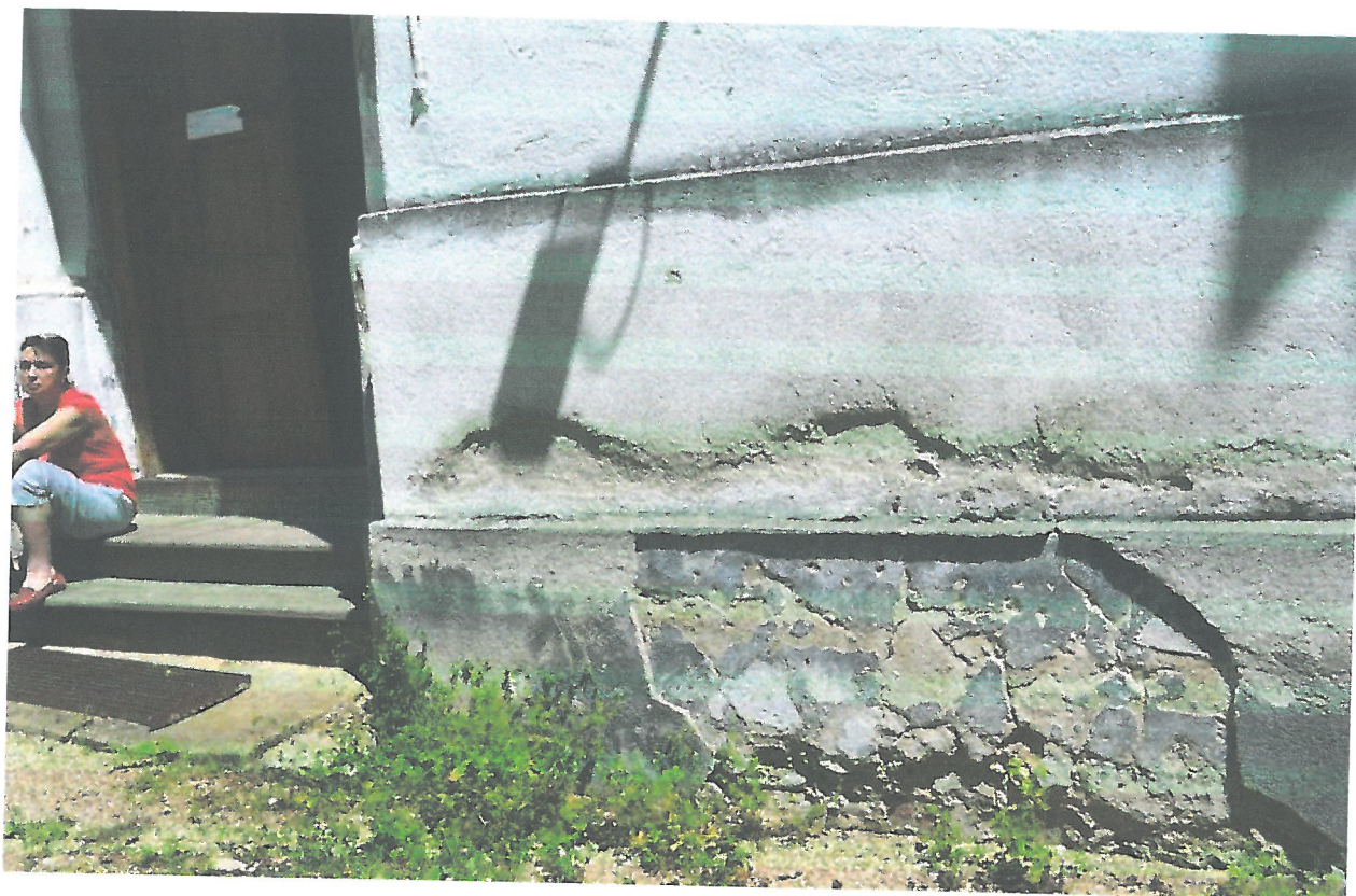
Foto 03 – Degradari din infiltratii de apa la baza zidurilor de vest
